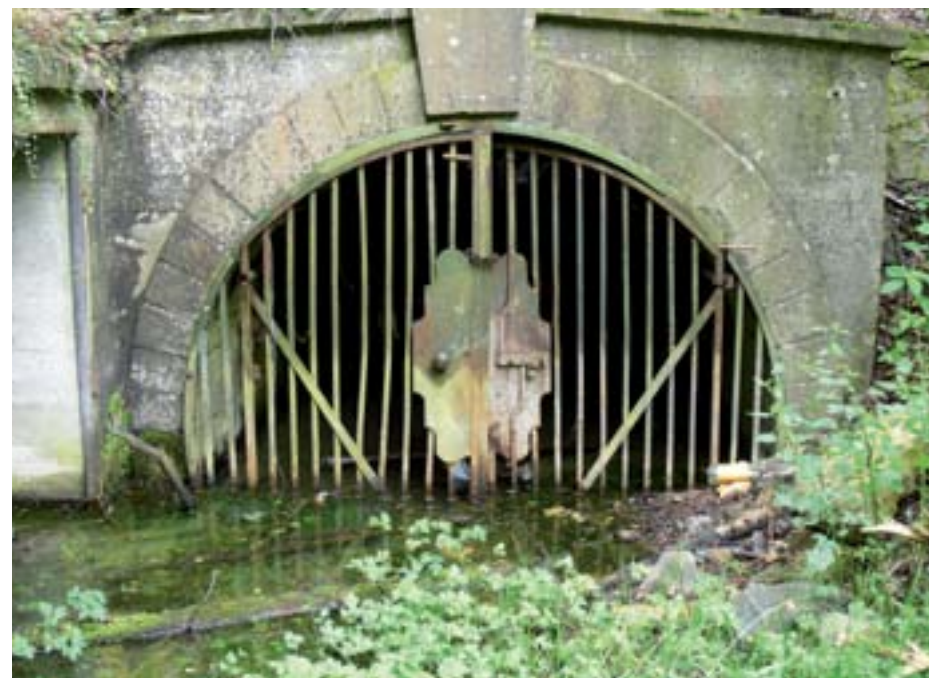
Obr. 14, 15: Příklad nevhodného zabezpečení vchodu do podzemních prostor. Foto: J. Šafář, J. Rejl
