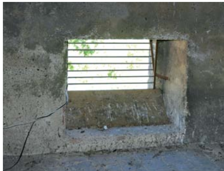
Obr. 9: Vhodné zabezpečení půdního prostoru proti holubům umožňující současně vlet netopýrů. Foto: V. Hanzal
